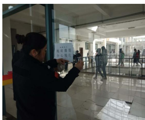
地砖损坏，张贴温馨提示
