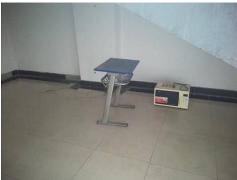
楼梯下乱堆乱放
