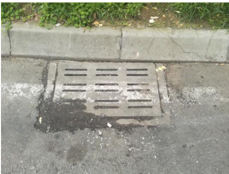
下水井盖堵塞
