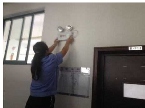
巡查发现应急灯掉落
