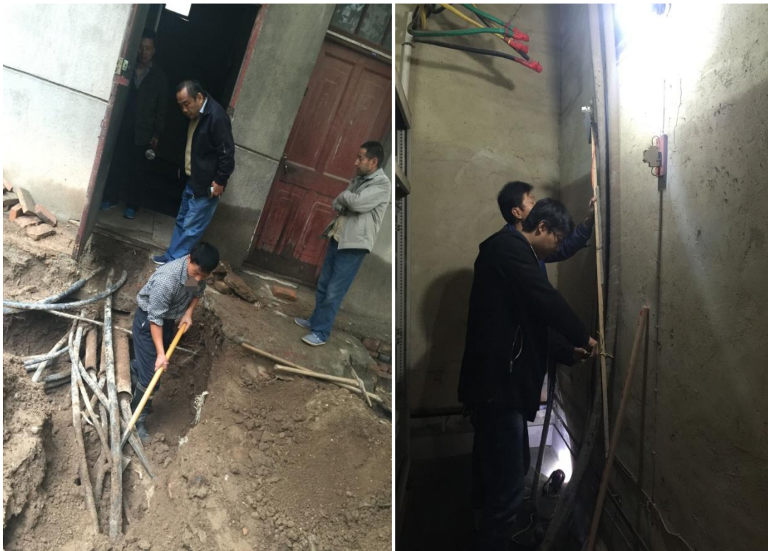
雁塔校区抢修家属区 2 号配 电室查看现场
