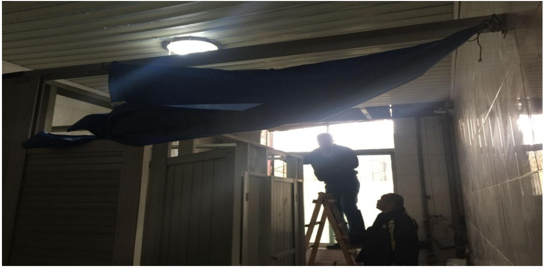
雁塔行政楼厕所漏水现场查看
