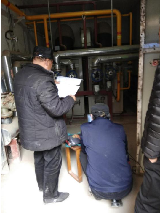
雁塔相关工作人员进行锅炉 操作培训
