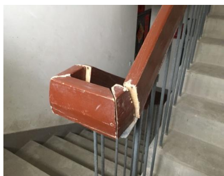
楼梯扶手断裂
