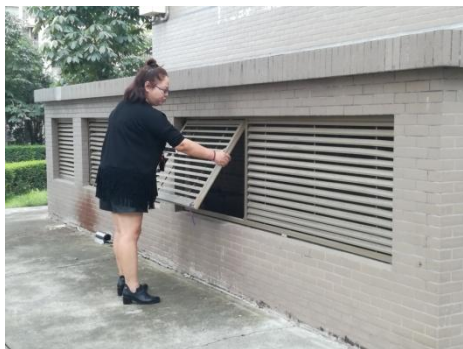
地下室通风口百叶窗坏
