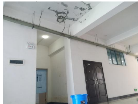
屋顶漏水（已上报）
