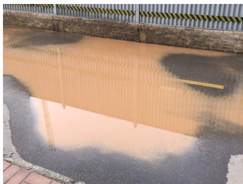
工地污水流入道路，联系基建方处理
