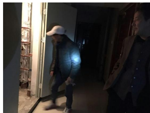
住户室内漏水，查看管道井阀门
