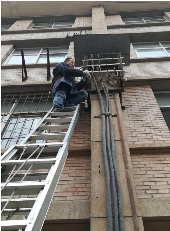
雁塔抢修考试中心电缆
